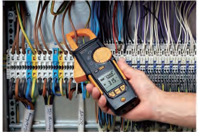
测量开关柜电流
