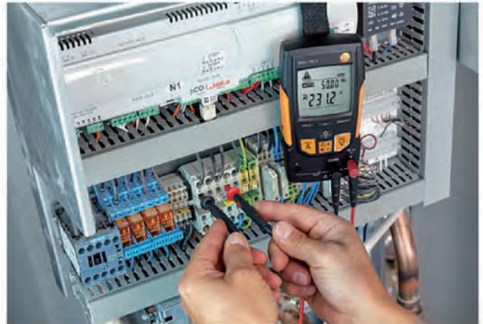
测量热泵开关盒中的电压
