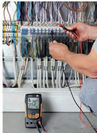
测量开关柜中的电压
